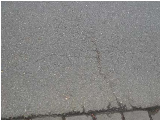
Abb. 9.1.-3: Netzrisse / wilde Risse / Frostrisse
